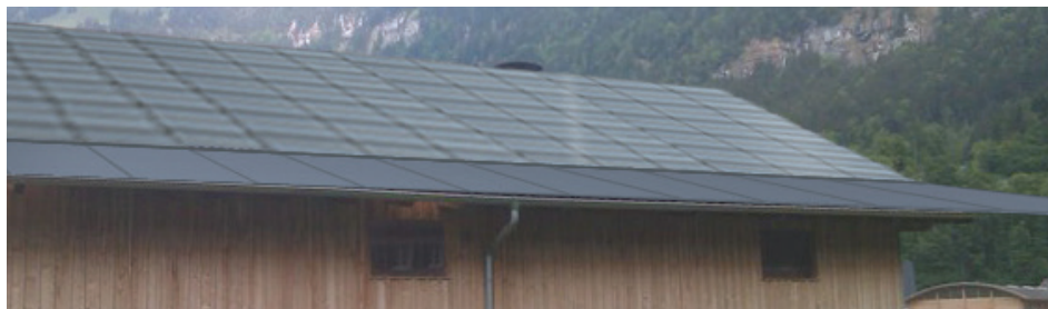
Abb. 5: Seit Jahren wird so eine optimal ganzflächige Solaranlage verhindert, die nicht nur viel schöner anzusehen wäre, sondern jährlich auch rund 80'000 kWh erzeugen würde. (Foto: Solar Agentur Schweiz)
